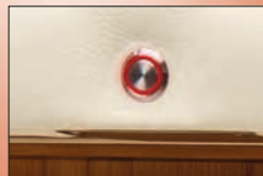
Schalter für Zentralheizung
